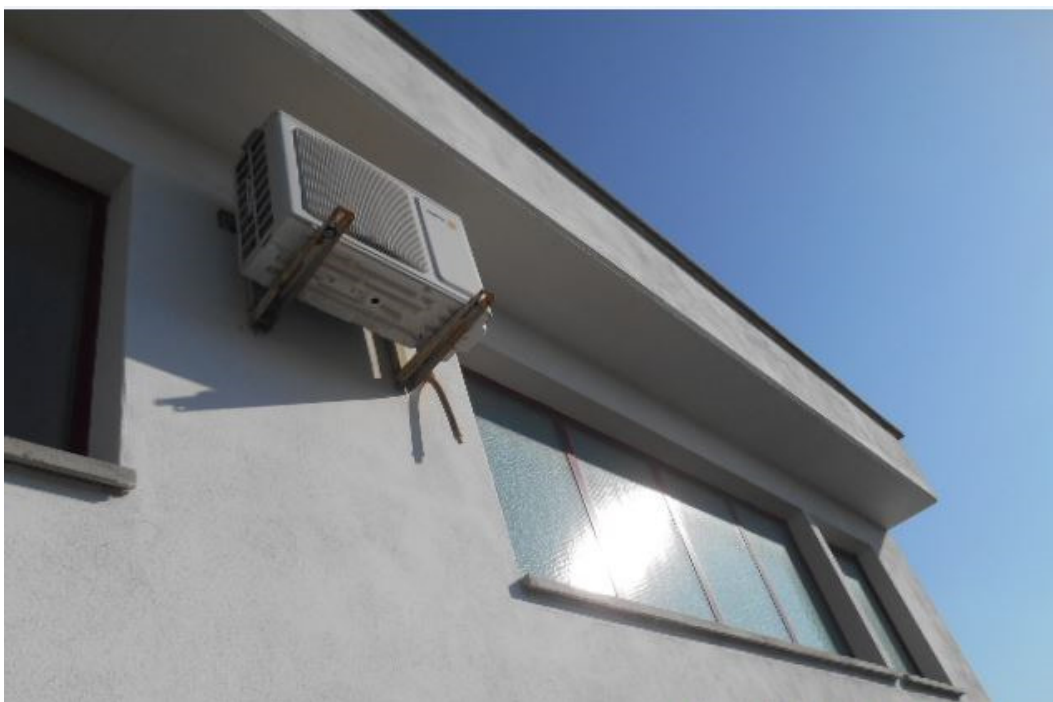
FOTO 13 Vista del Magazzino dall'esterno con motore split a servizio del locale ufficio
